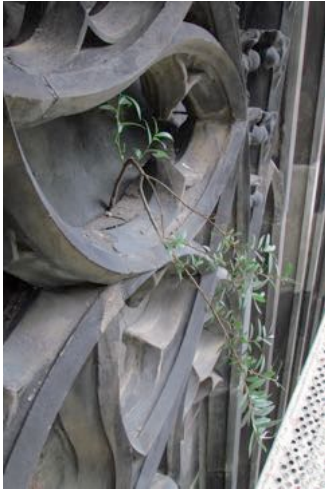
Abb. 5 Prag, St.-Veitsdom. Detail eines dekorativen Masswerks an dem Strebpfeiler Nr. 11 mit Pflanzen und dem Mörtel aus verwitterten Fugen
