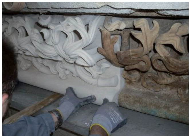
Abb. 8 Fries, teilweise gefestigt, teilweise steinmetzmäßig erneuert
