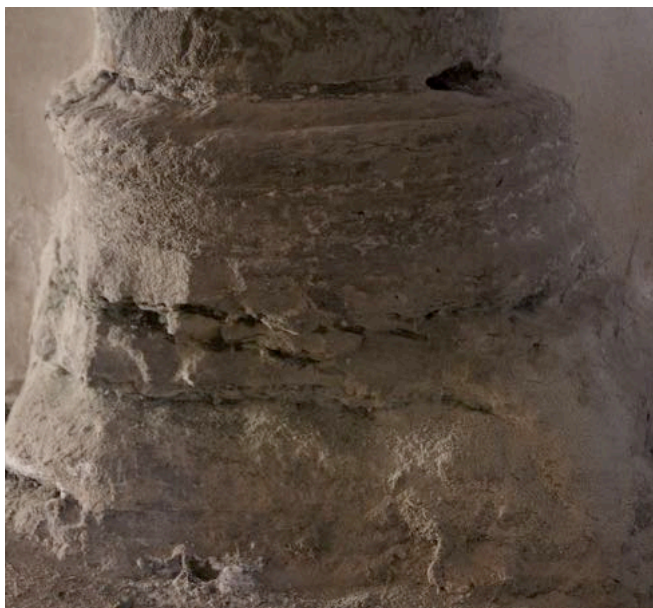
Abb. 4 Steinschäden aufgrund Versalzung und Durchfeuchtung vor Baubeginn, 2015. Foto HARTKOPF denk mal architektur
