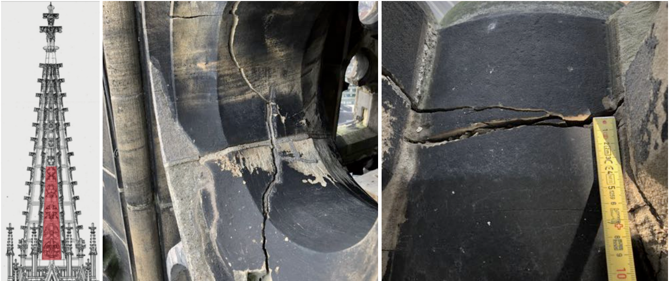
Abb. 5 Schadensbilder Turmhelm Sommer 2018, Zeichnung und Fotos Stiftung Basler Münsterbauhütte
