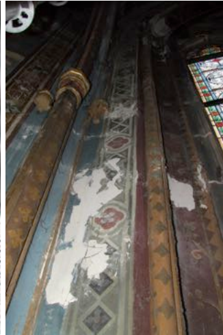
Abb. 6 Prag, St.-Veitsdom, Marienkapelle. Die ältere Beschädigung der Wandmalerei aus den Jahren 1895–1903
